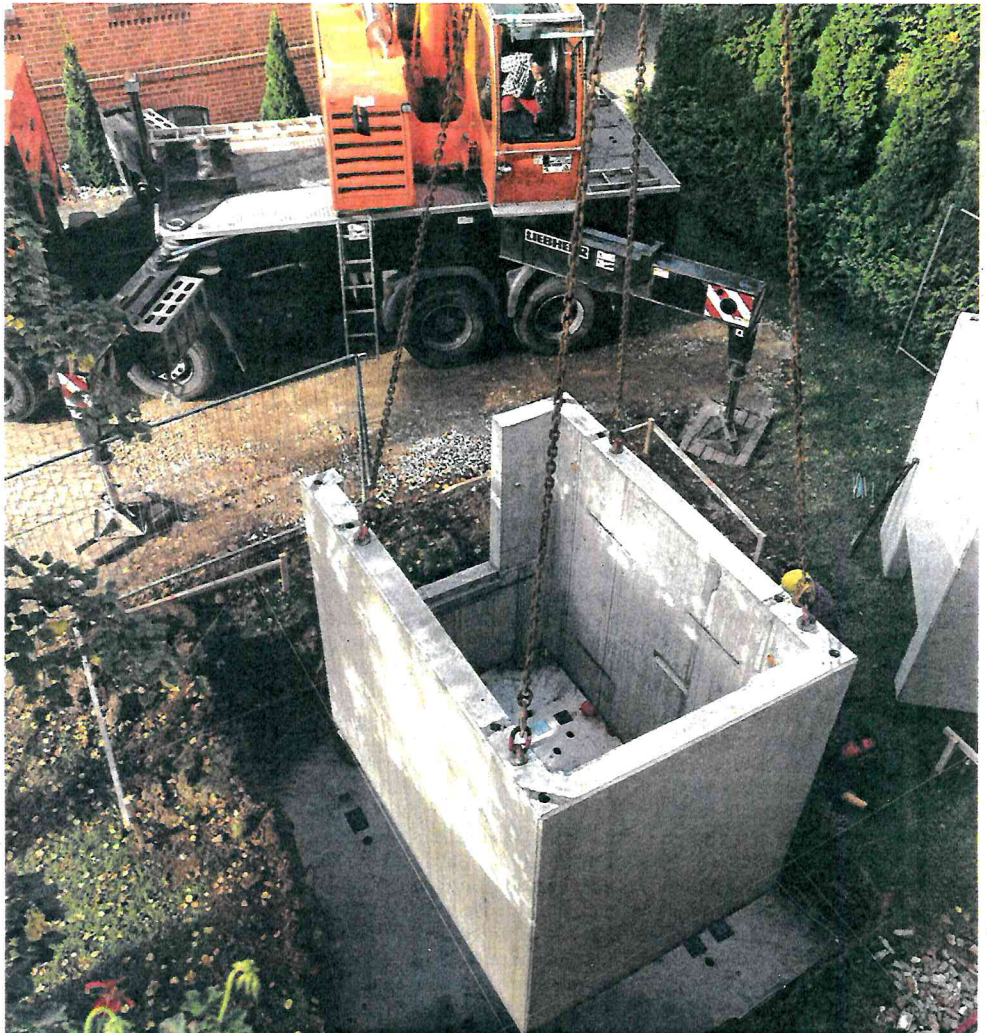
Etwa elf Tonnen schwer ist jedes Element, das der Kran zu einem Fahrstuhlschacht aufstapelt. Der wird dann über Brücken mit dem Gebäude verbunden. FOTO: FREDERIC PREUß
